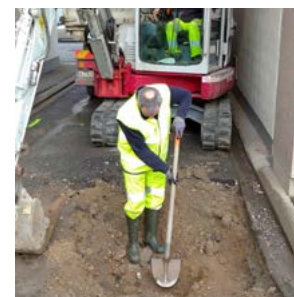
Les astreintes des services techniques mobilisées pour les problèmes urgents
